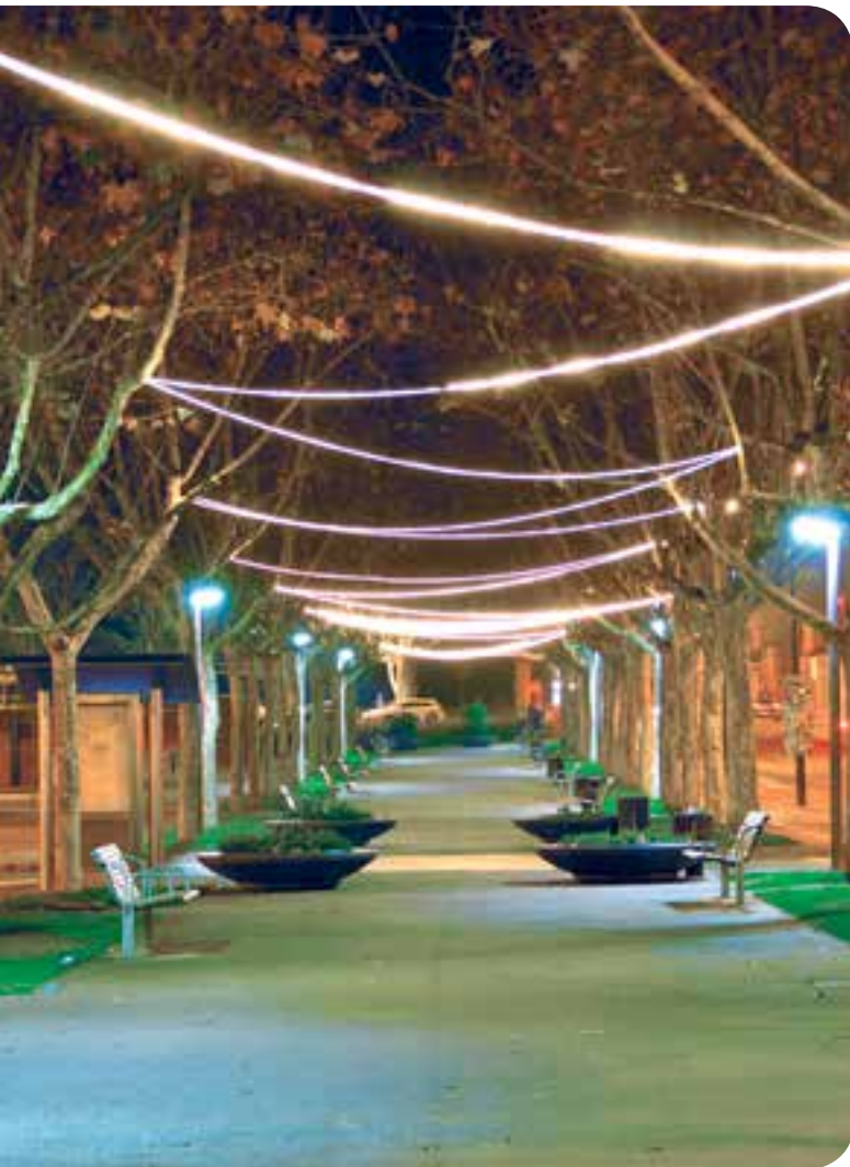
Manguera de luz LED en forma de zig zag sobre árboles de una avenida (IBR13WWL)
